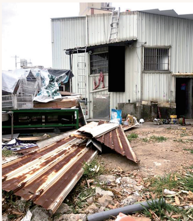
圖：地上為屋頂修繕施工後拆卸的老舊鏽蝕鐵皮屋頂
