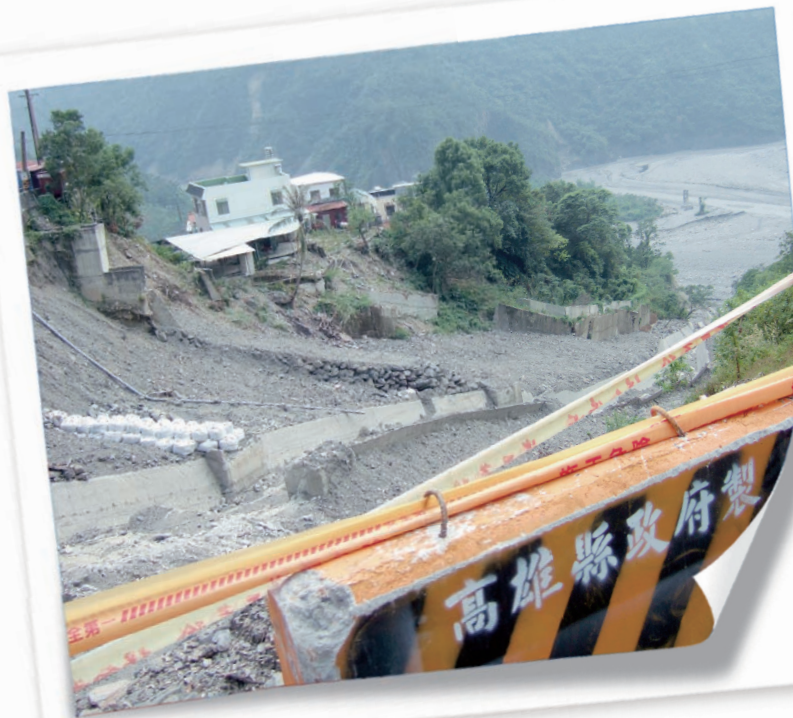
茂林鄉在八八風災時受到嚴重土石流冲刷的公路及民房
